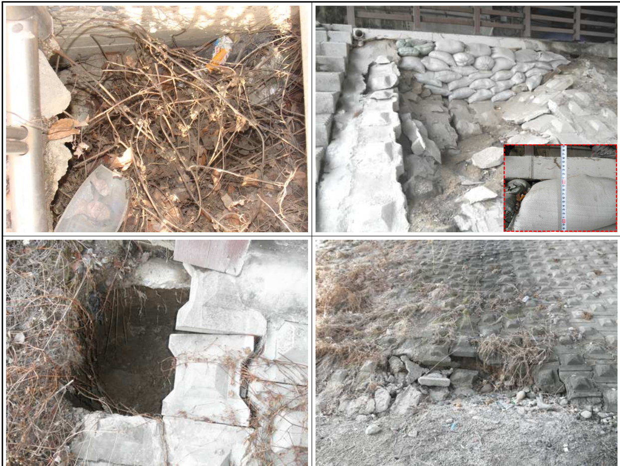
교대(A1) 배면 세굴 및 전면 호안블록공 침하 및 유실 현황
